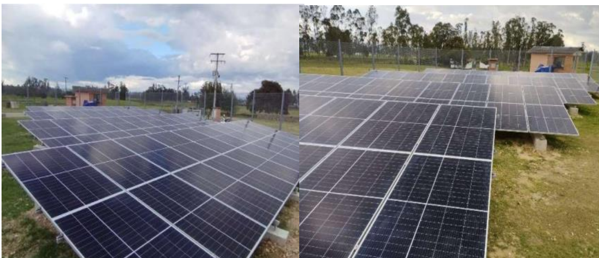
Sistema Fotovoltaico Hacienda Galindo
